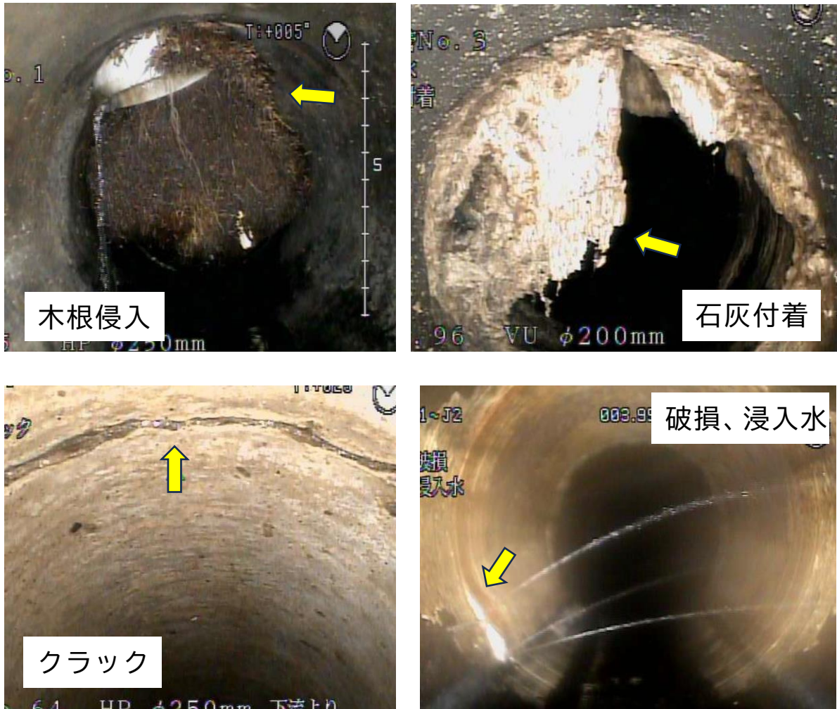
図7 下水道管の老朽化、破損状況
