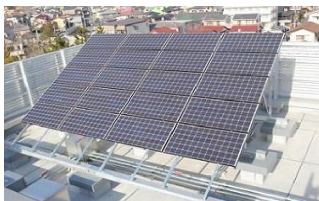
太陽光パネル (南消防署屋上)
