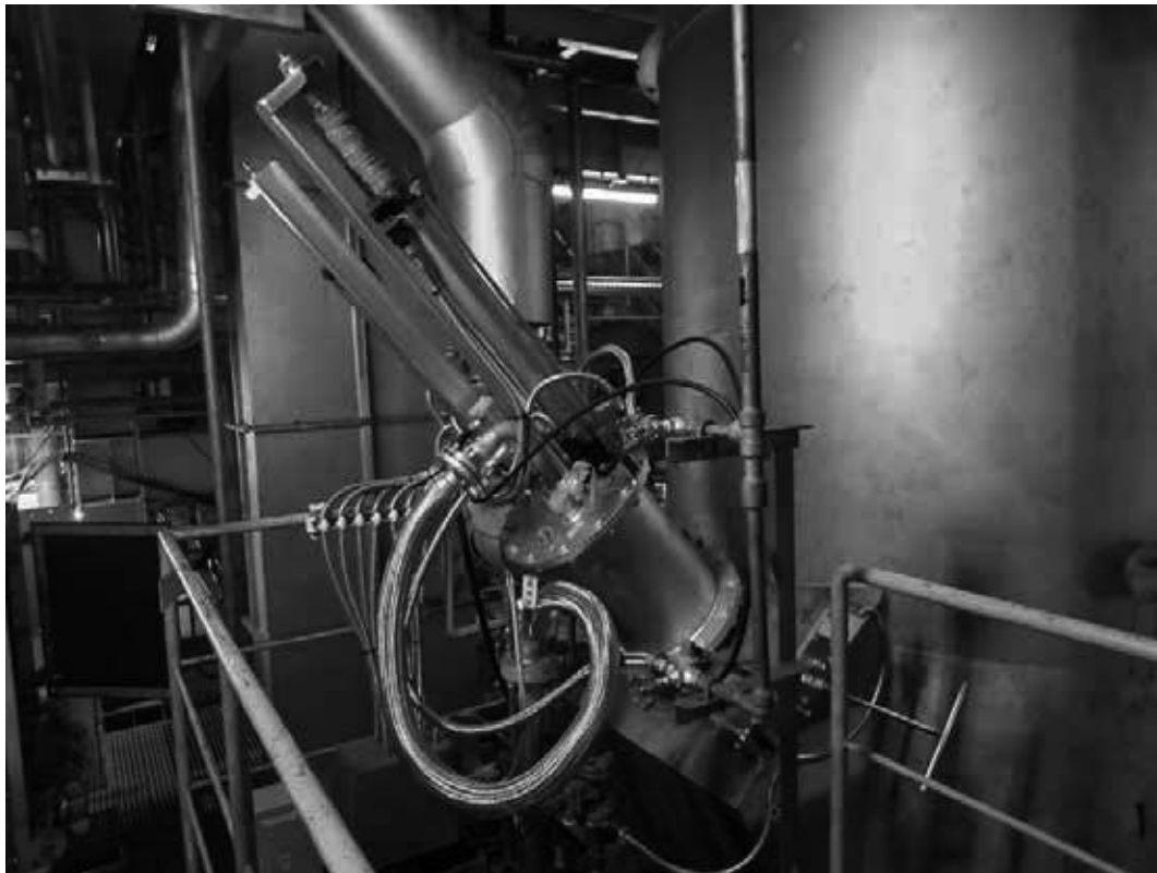
ガス化炉バーナー
