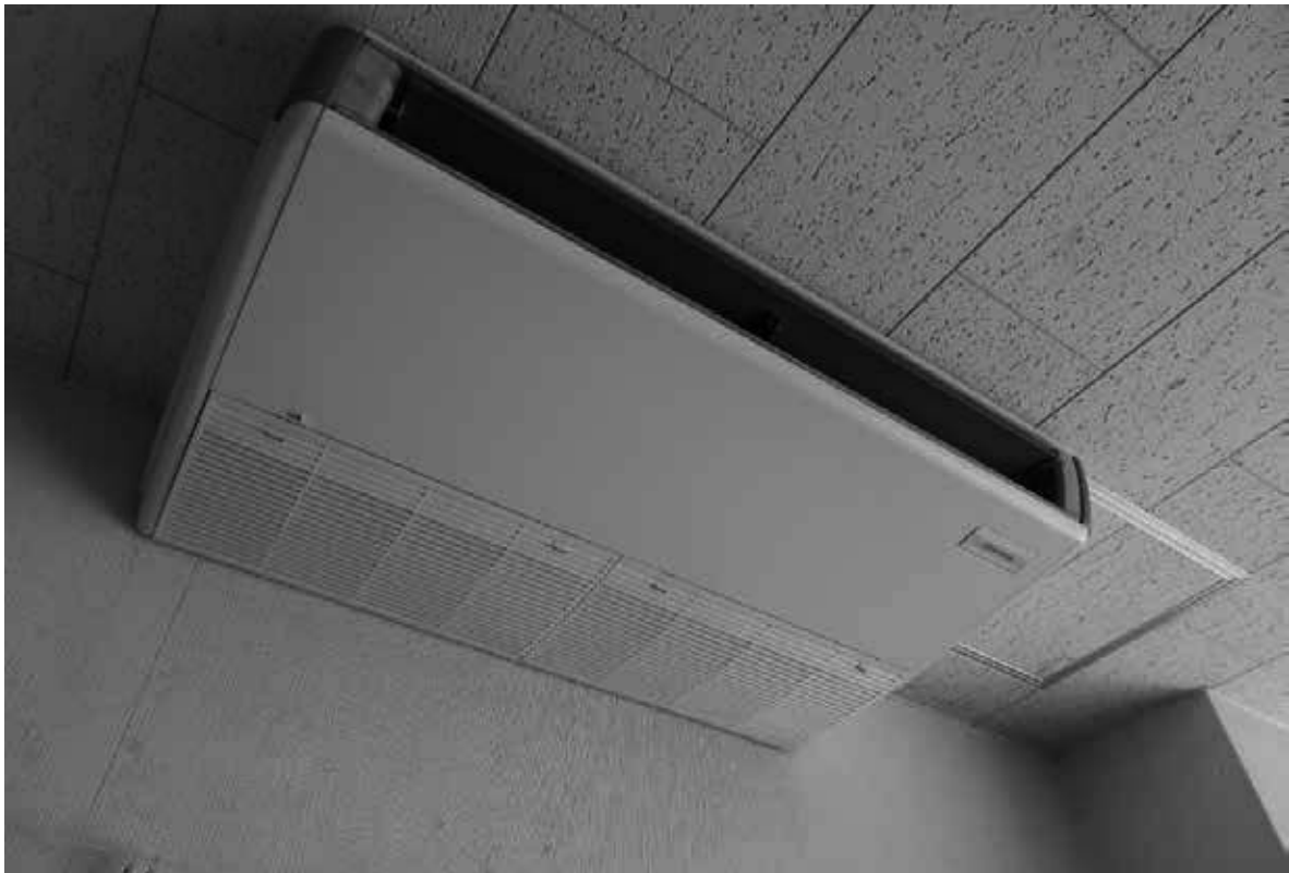
保育室の空調機
