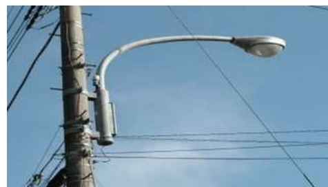
道路照明灯（設置例）
