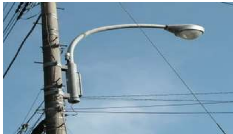
道路照明灯（設置例）
