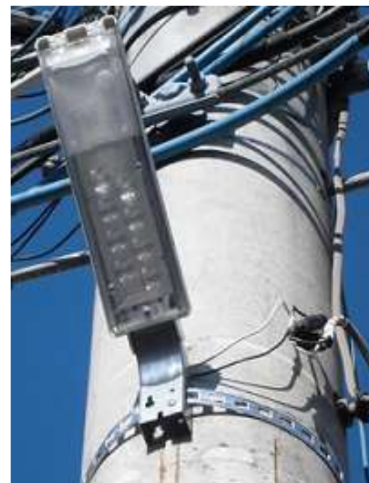
防犯灯(電柱共架型)
