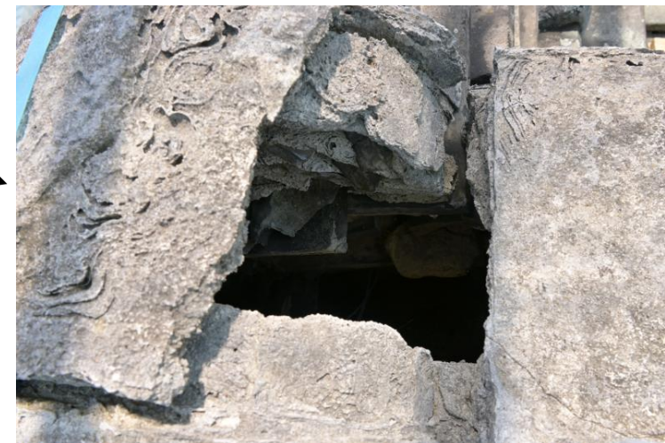
影盛が割れて、雨漏りの原因に。
