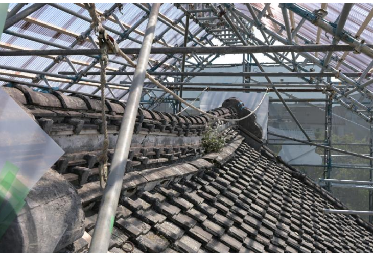
屋根の中央が凹んでいる。
