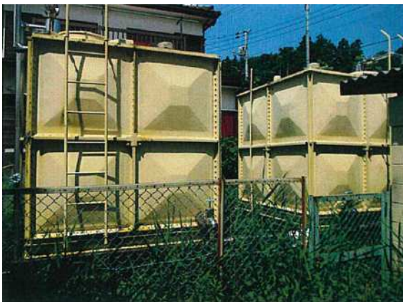
令和5年度に更新予定の大橋団地1・2号棟受水槽
