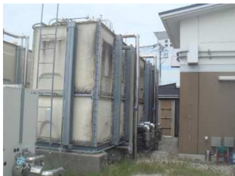
令和5年度に改修予定の下花輪福祉会館の受水槽
