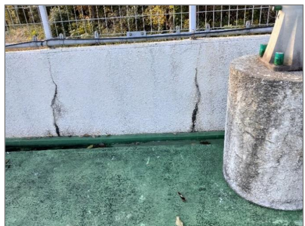
壁面老朽箇所
