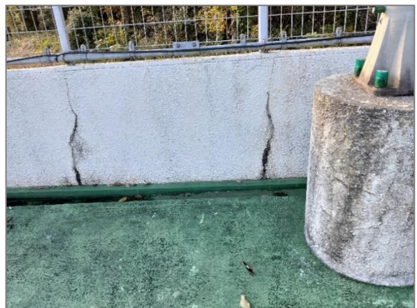
壁面老朽箇所
