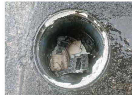
▲蓋が割れた污水ます
