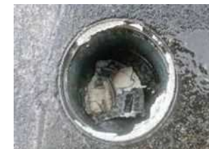
▲蓋が割れた汚水ます
