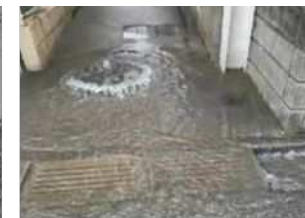
▲雨水があふれる汚水ます
