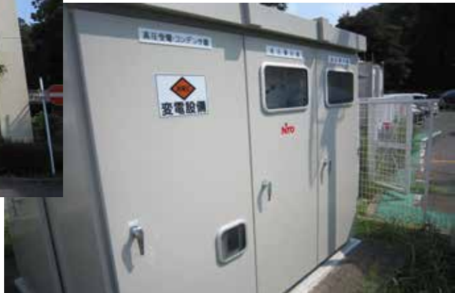
改修後の保健センター外観及び受変電設備
