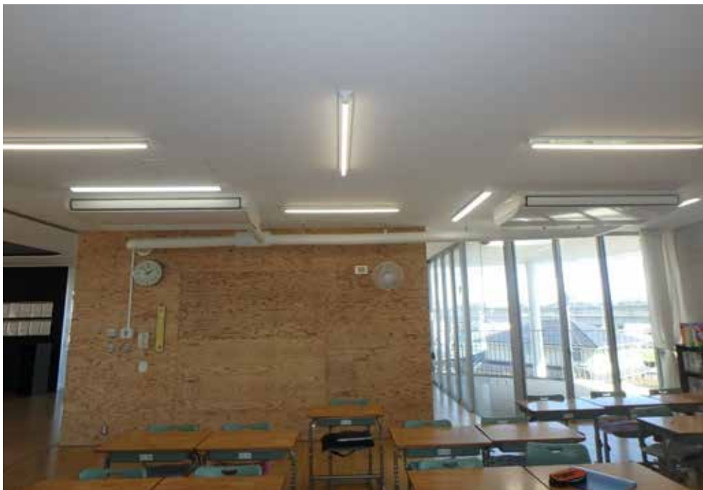
おおたかの森中学校エアコン設置状況
