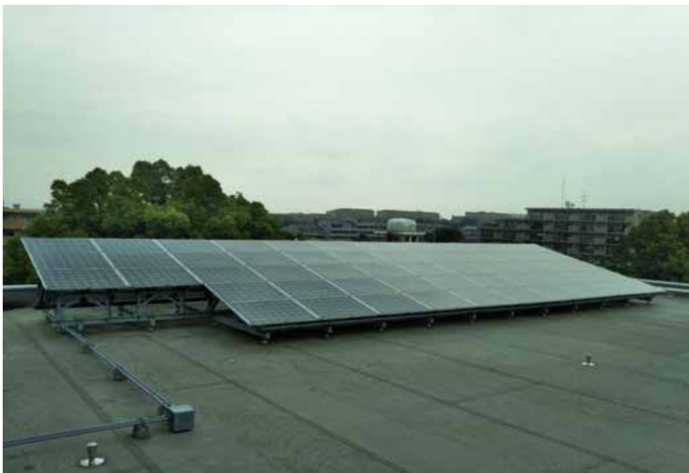
太陽光パネル
