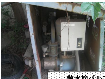
散水栓バルブ
