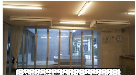
教室に配置されたエアコン
