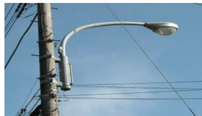
道路照明灯例
