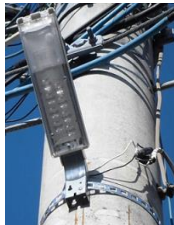
防犯灯（電柱共架型）
