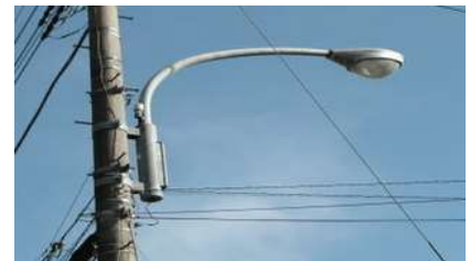
道路照明灯例
