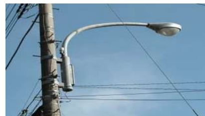
道路照明灯例
