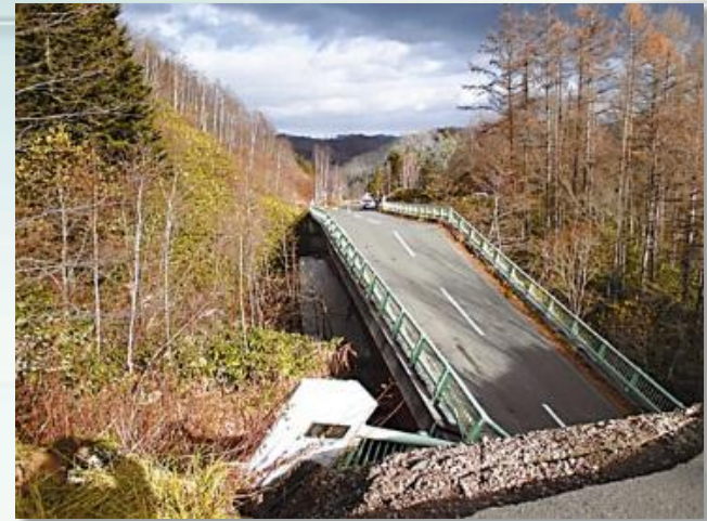
洞爺湖町：伏見橋崩落事故※3
