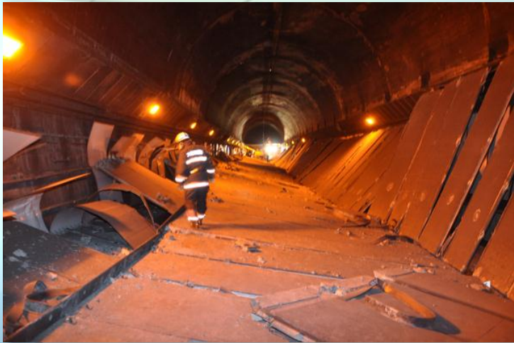
笹子トンネル崩落事故：山梨県警報道提供資料※1
