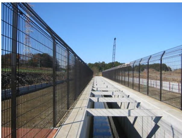
雨水排水施設（野々下1丁目）
