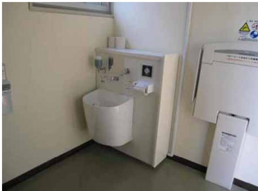
東部公民館障害者用トイレに設置したオストメイト対応トイレ
