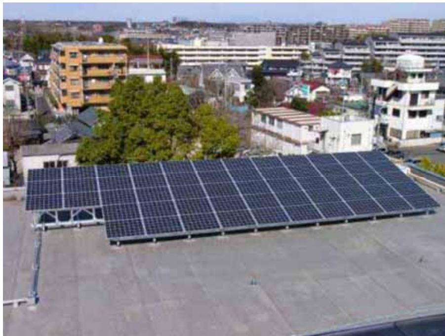
市役所第2庁舎に設置している太陽光パネル
