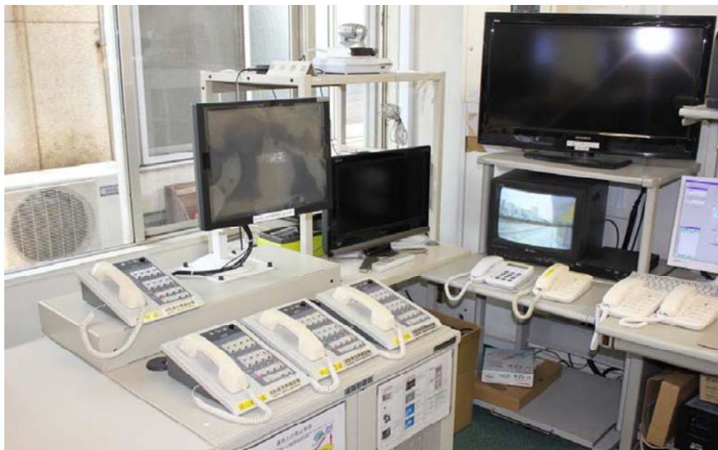
消防救急デジタル無線遠隔制御器の様子
