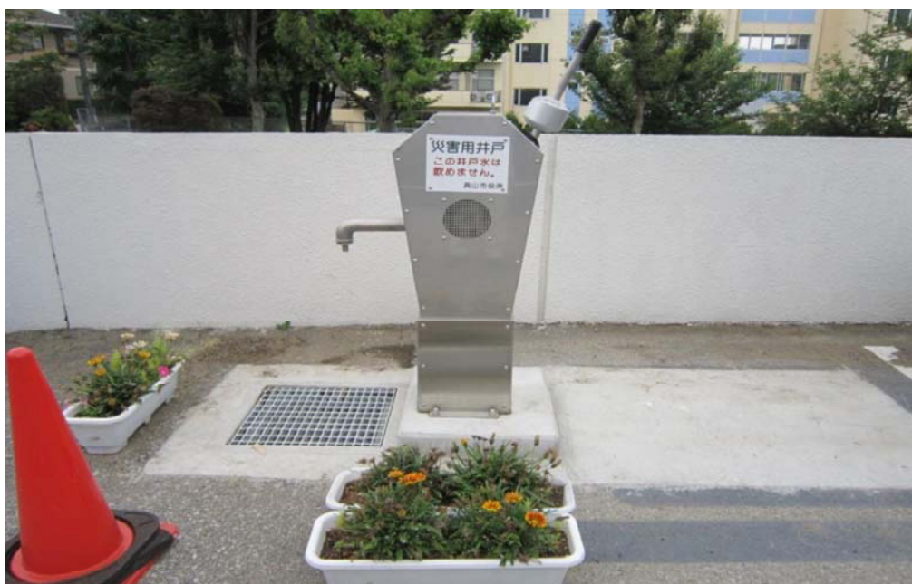
中央公民館に設置した災害用井戸
