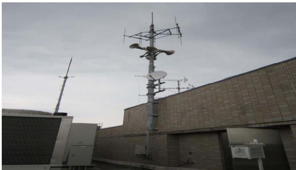
市役所屋上の防災行政無線
