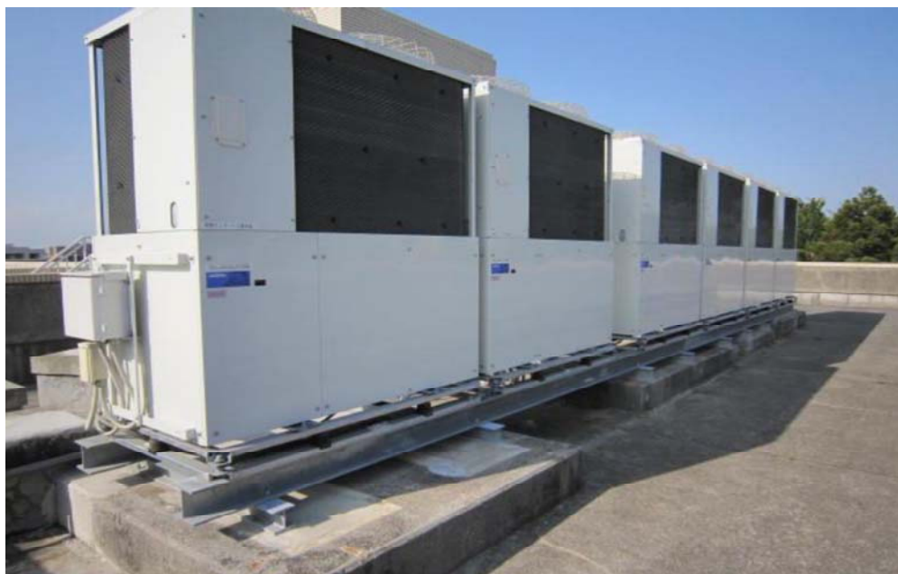
保健センター空調設備
