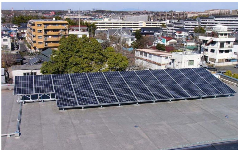
市役所第2庁舎に設置してある太陽光発電設備
