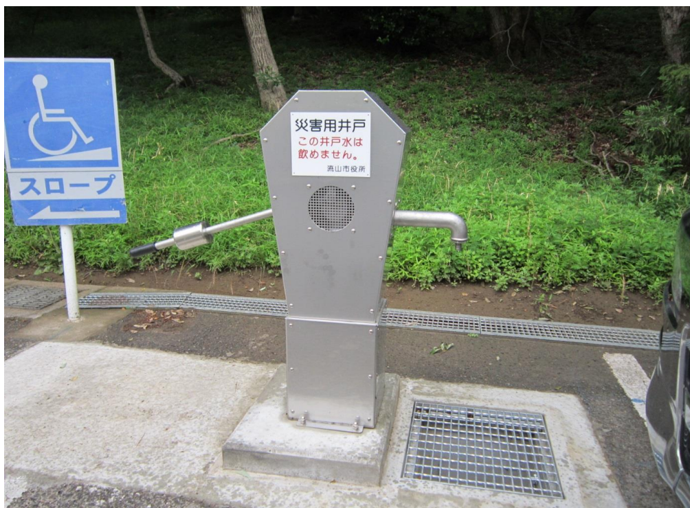
東部公民館に設置した災害用井戸
