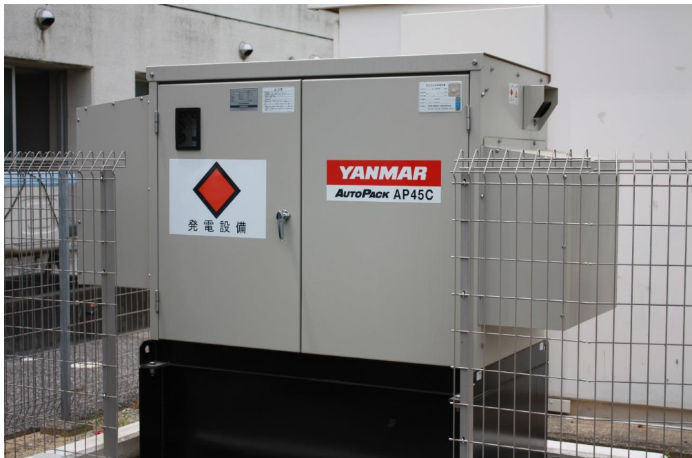
北・東署に設置した非常用発電設備
