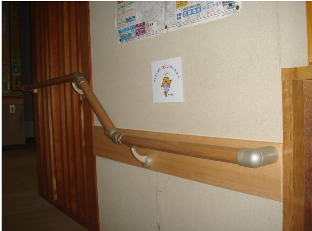
名都借福祉会館に設置した手摺り
