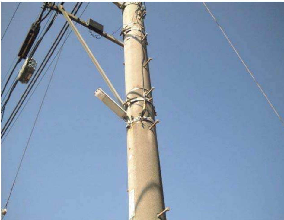
夜間における通行者の安全を確保する防犯灯
