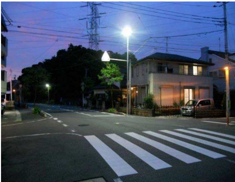
交差点に設置した道路照明灯
