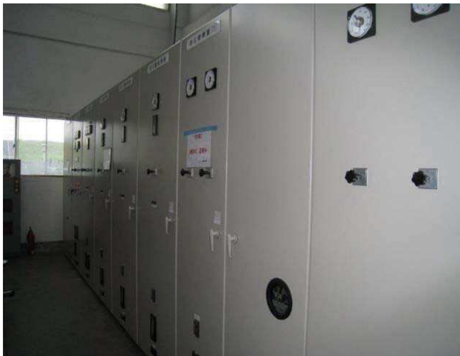
更新後の流山排水機場内の配電盤
