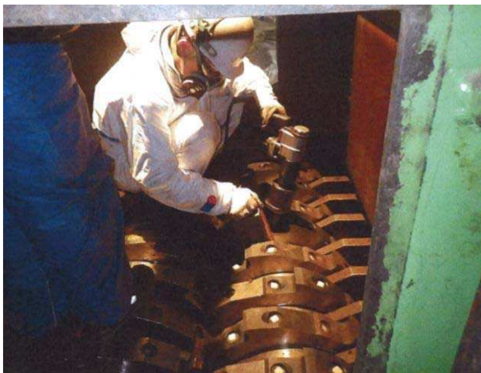
リサイクル館定期年次点検整備の様子
