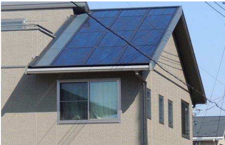
住宅用太陽光発電設備
