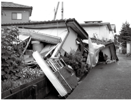
昨年発生した新潟県中越沖地震による被害
