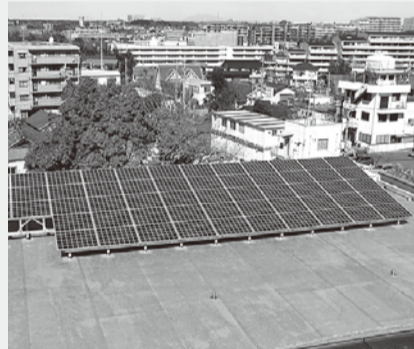
市役所屋上に設置された太陽光発電設備
