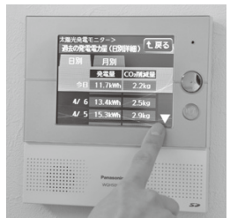
太陽光発電設備のモニターパネル
