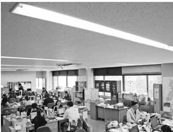
事務室内の照明をLED化
