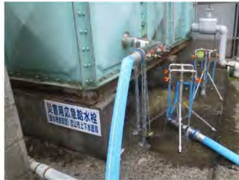
図 3 小学校の受水槽に設置した応急給水栓
