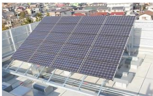
太陽光パネル (南消防署屋上)
