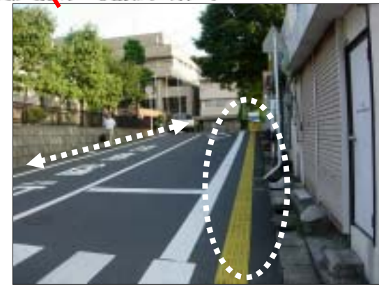
地形上、縦断勾配がきつい 歩道がない 誘導ブロックの一部に老朽がみられる
