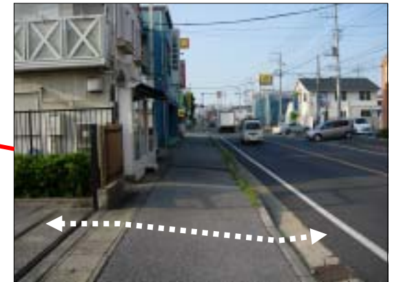
車乗り入れ部の切下げにより、歩道の 横断勾配がきつい
