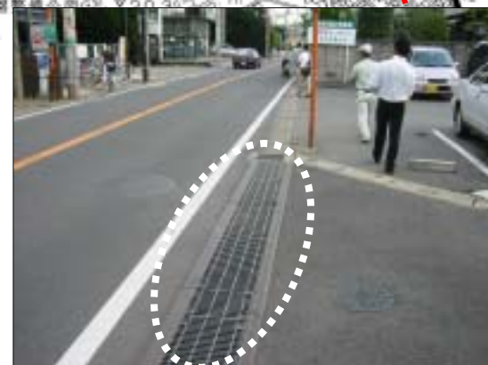
歩道がない グレーチング目が大きい
