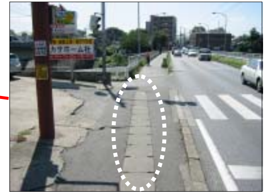
歩道内にU字溝がある。不陸、ひび割れ
