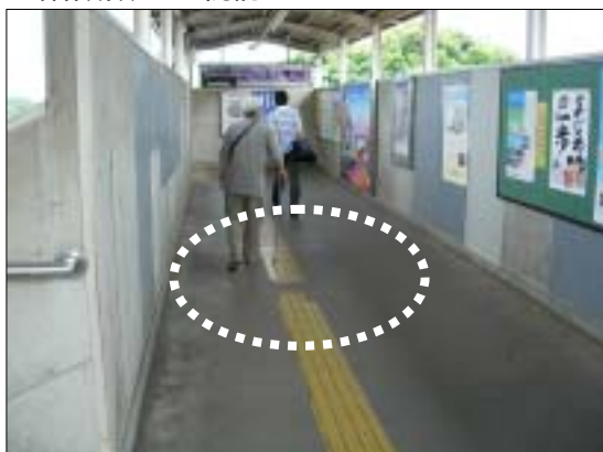
誘導ブロックが老朽化してはがれている
