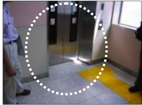
エレベーターが設置されている
