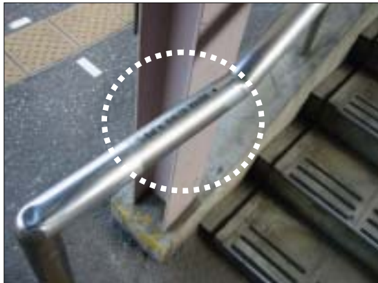
階段手摺に方面等の点字表示あり 階段段差が視認しづらい
