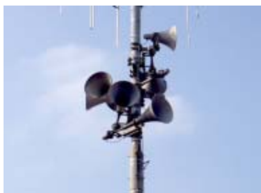
防災行政無線子局増設事業 (街頭に設置された防災行政無線の屋外スピーカー)
