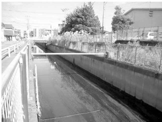
川幅、深さ共に不足していた河川（神明堀）
