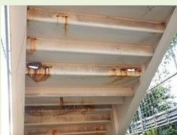
階段：変形・欠損
