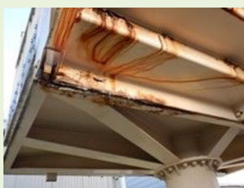
上部構造との接合部：腐食
