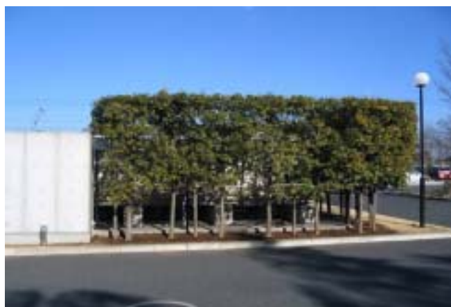
空調や給排水の屋外機器類を目立たなくなるよう、緑で遮へいする。
