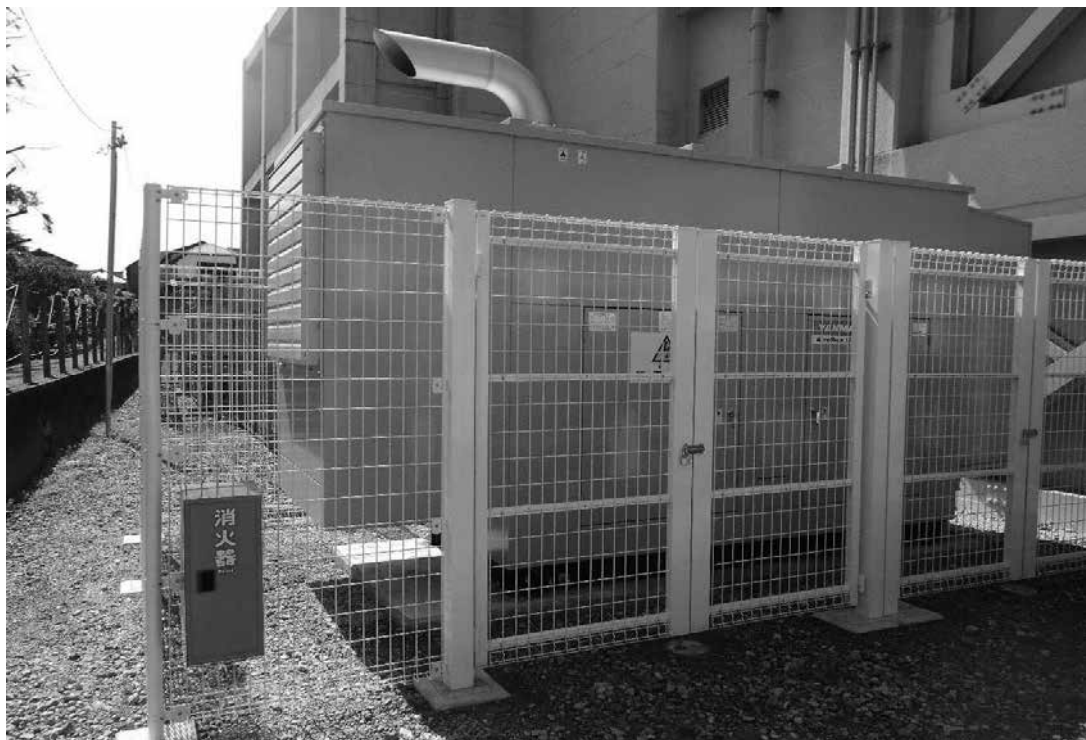
非常用発電機
