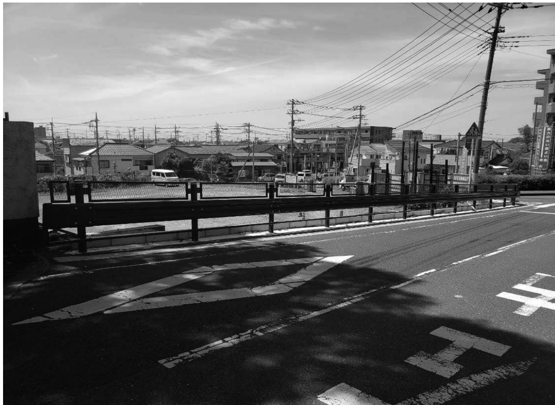
市役所出入口付近店舗解体後及び設置した転落防止柵
