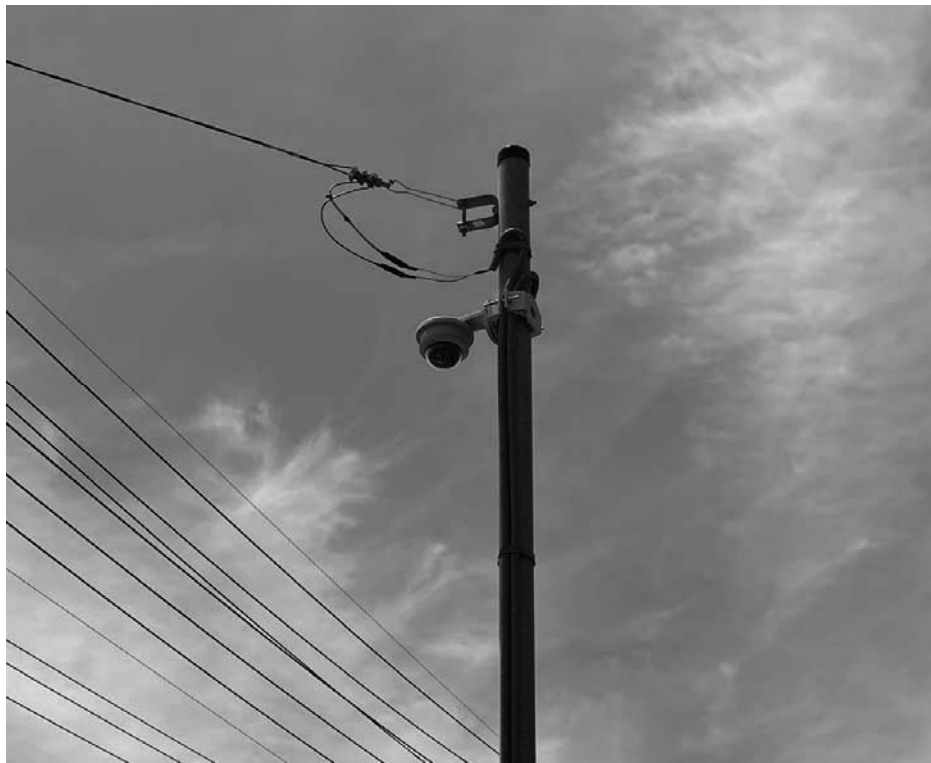
設置した防犯カメラ
