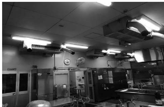
上段：長崎小学校給食室 下段：給食室及び調理場への空調設置
