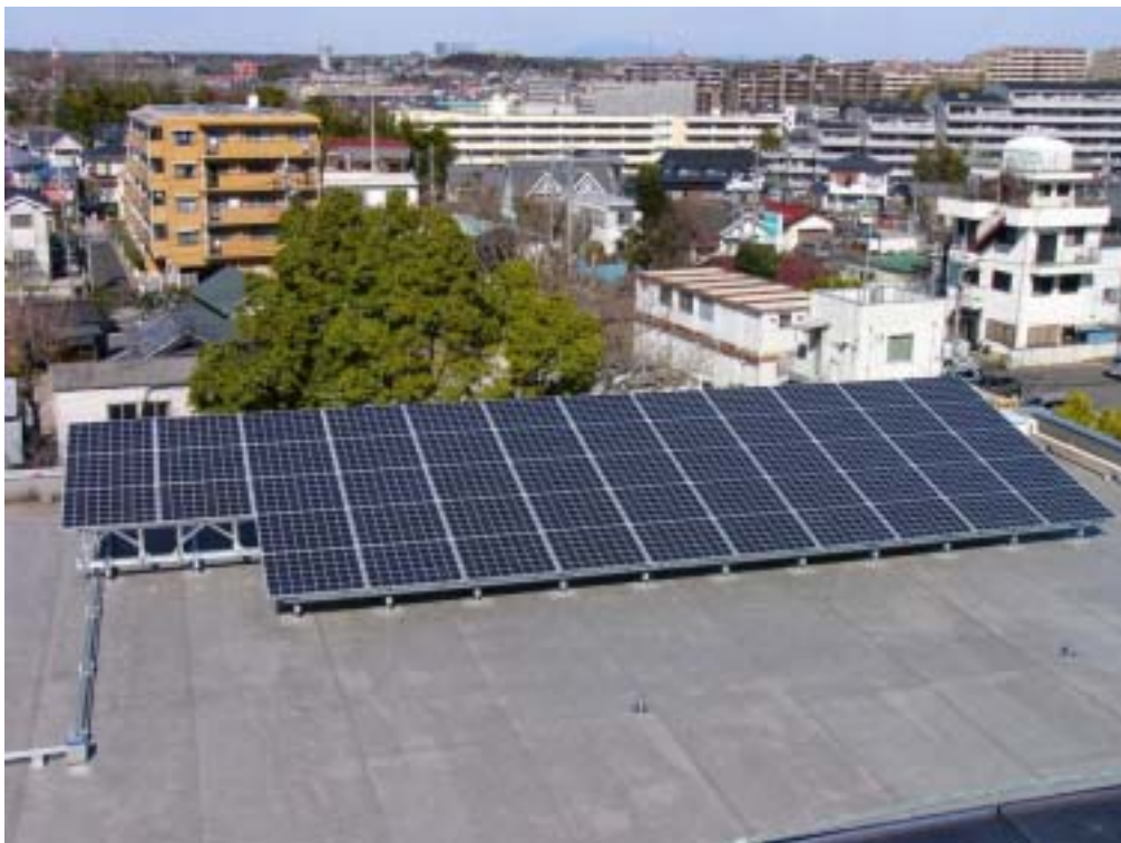
新第2庁舎屋上に設置された太陽光発電パネル
