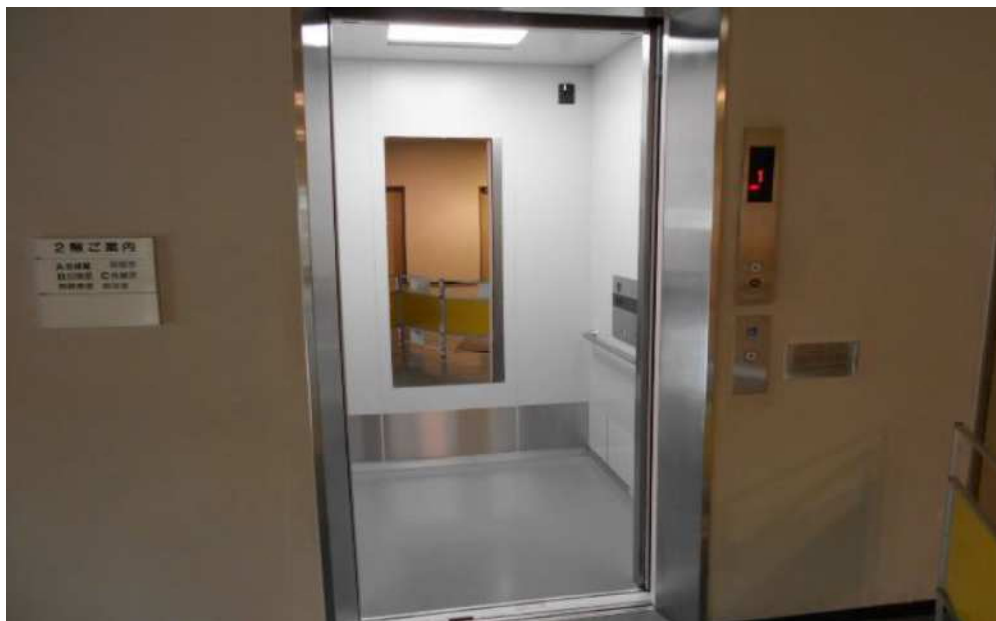
最新基準に適合した施設内エレベーター
