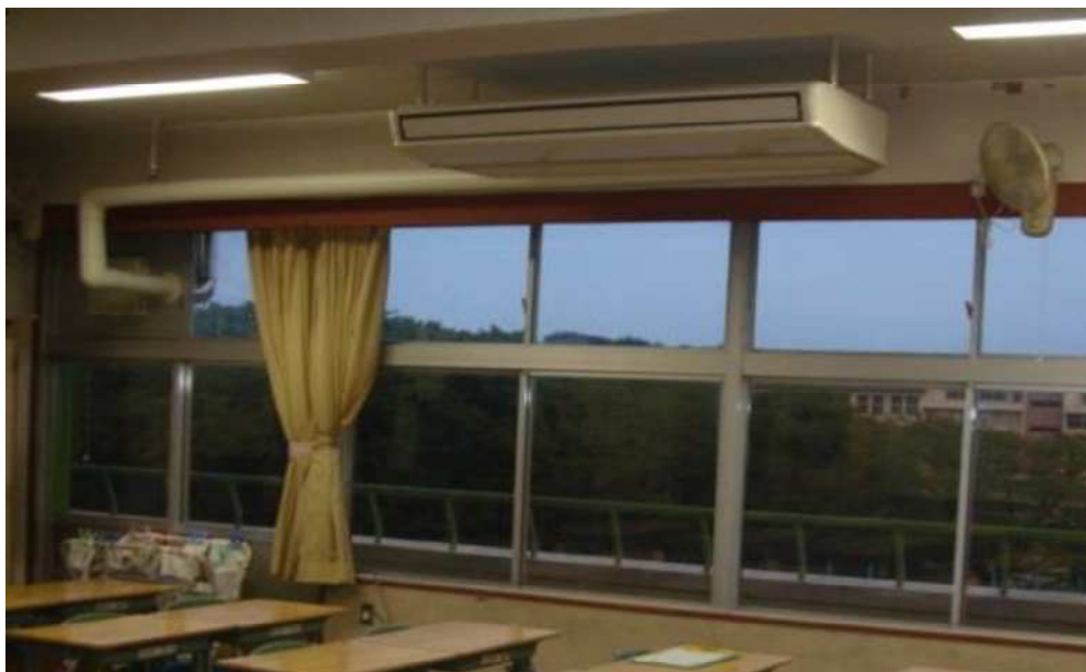
空気調和設備を設置した教室の様子
