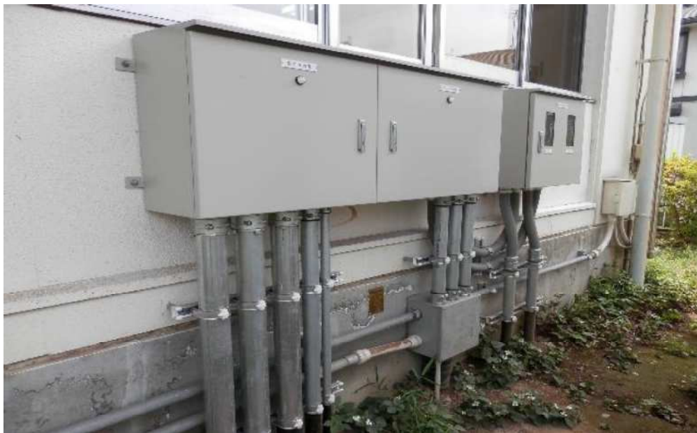
更新された分電盤
