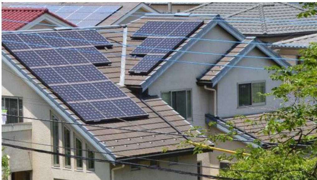
太陽光発電設備
