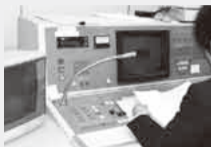
市庁舎内の防災行政無線室
