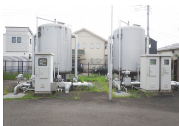
更新予定のろ過機
