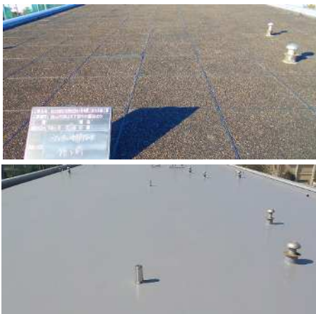
屋上防水整備を実施した柳田団地3号棟 上：施工前 下：施工後
