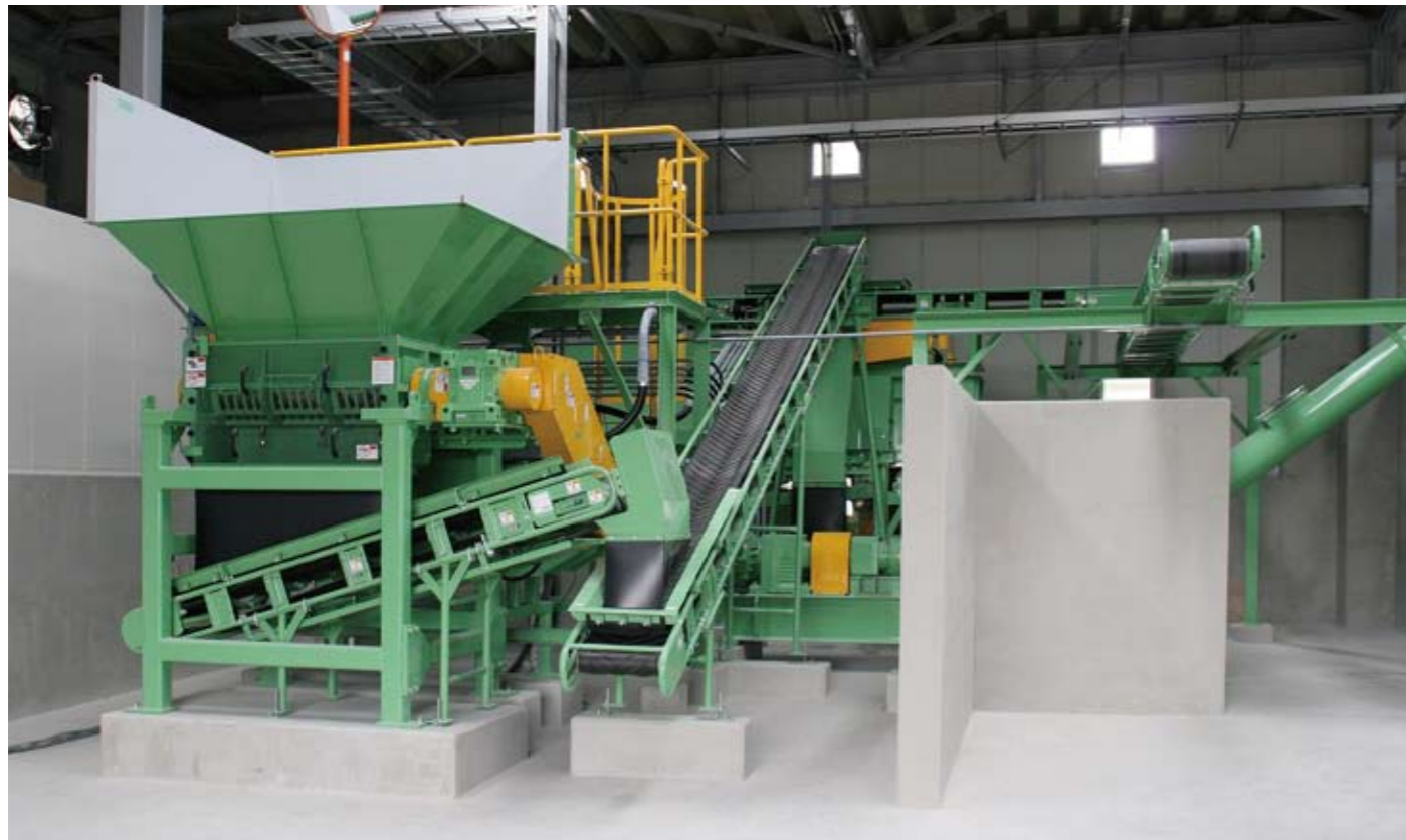
■剪定枝資源化設備
