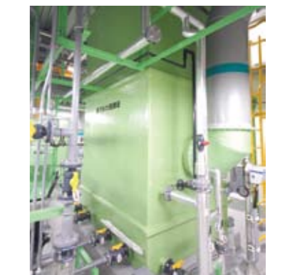
■酸・アルカリ脱臭塔
