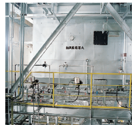
12 触媒反応塔 排ガス中の窒素酸化物・ダイオキシン類を、アンモニアガスと触媒により除去します。
