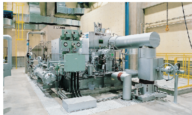
6 蒸気タービン発電機 廃熱ボイラから発生する蒸気を利用して発電します。
