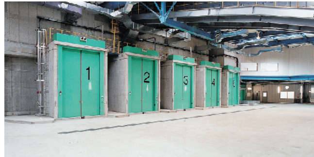
1 プラットホーム プラットフォームは、屋内に設置され、臭気が外部にもれないようエアカーテン及び脱臭装置を完備しています。
