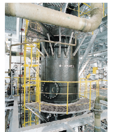
11 排ガス洗浄塔 高温排ガスを多量の水噴霧により急冷します。また、排ガス中の塩化水素、硫酸化物を苛性ソーダにより除去し水銀を液体キレートにより除去します。
