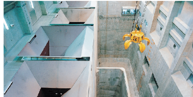
2 ごみピット&クレーン ピット&クレーン方式により、ごみを攪拌・均質化した状態でごみホッパーへ投入します。
