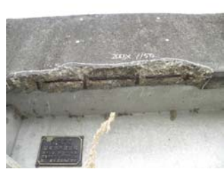
損傷箇所：地覆 損傷状況：鉄筋の露出
