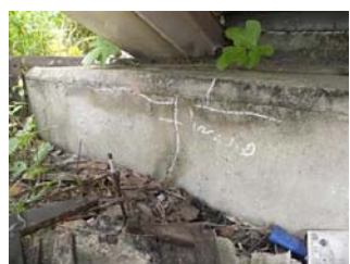
損傷箇所：橋台 損傷状況：ひびわれ
