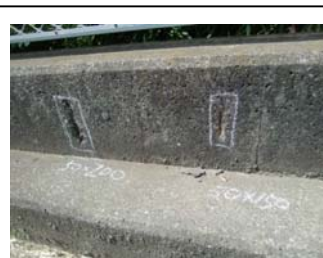
損傷箇所：防護柵 損傷状況：鉄筋の露出
