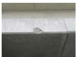
損傷箇所：橋桁 損傷状況：欠損
