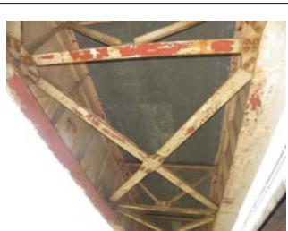
損傷箇所：橋桁 損傷状況：塗装の劣化
