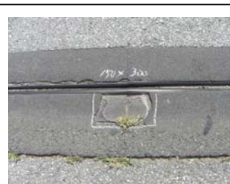
損傷箇所：伸縮装置 損傷状況：欠損
